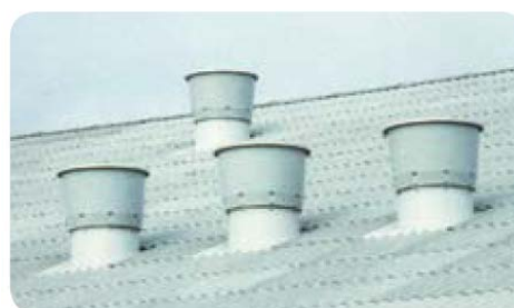
Figur 9 Ventilation på slagtekyllingestald. Kilde: Skov.dk.
