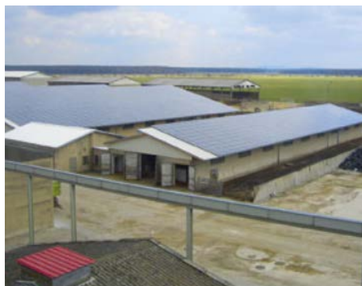
Figur 26 Solcelleanlæg monteret på staldtag. Kilde: teknordisk.dk.
